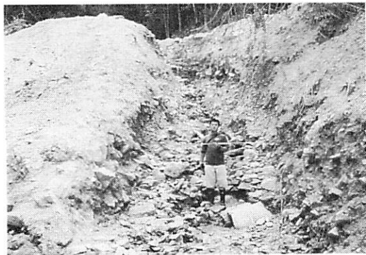
写真13 亀山3丁目における沢の侵食状況
