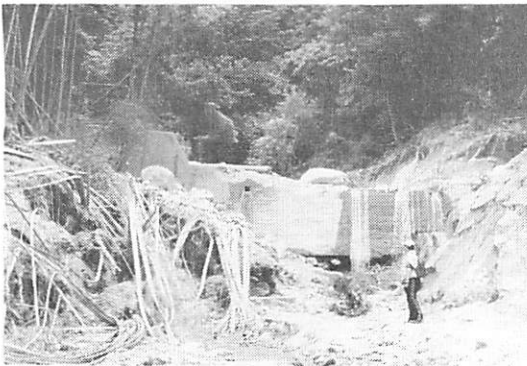
写真9 右岸側袖部が損壊した堰堤
