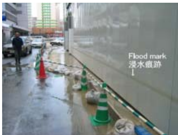
写真 2 JR 博多駅筑紫口付近の浸水痕跡
