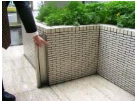
写真-1 博多都ホテルの止水板取り付け金具．指の位置まで浸水したとのこと
