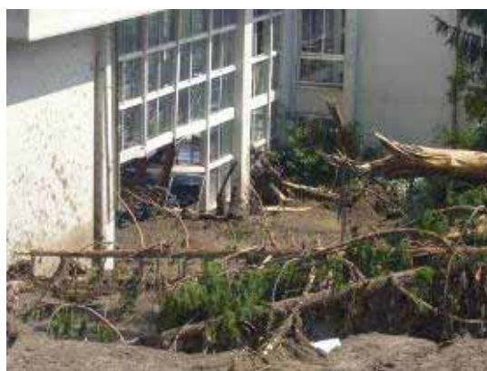
写真 5 長野県岡谷市上ノ原小学校体育館に流入した土砂と流木。7月22日牛山撮影。
