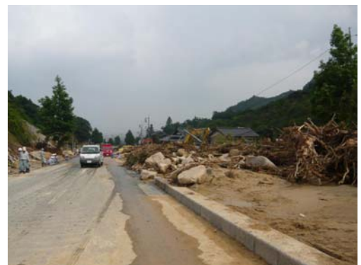
写真1 国道262号被災現場
