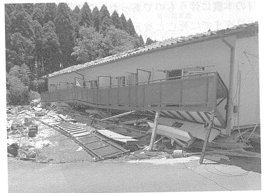
写真7 1982年新築で犠牲者が発生したと推定されるアパート2棟（いずれも南阿蘇村河陽）
