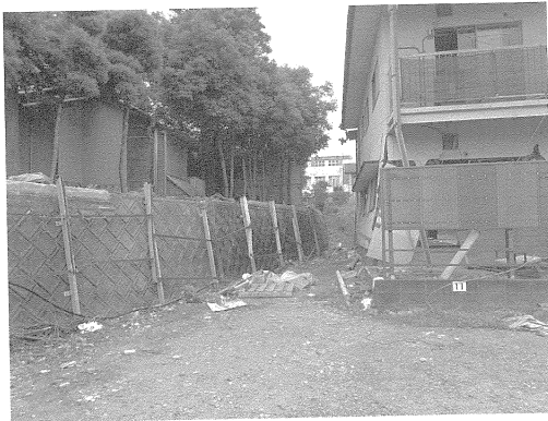
写真6 左手石垣上にあった高さ約2mのブロック塀が倒壊し、写真中央付近で犠牲者が発生と推定される。
