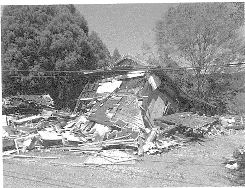
写真5 震度5強で「倒壊」による犠牲者が発生したと推定される場所
