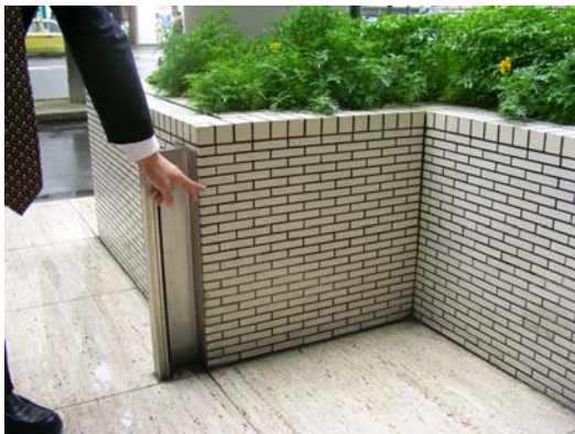
写真 7.1 博多都ホテルの止水板取り付け金具。指の位置まで浸水したとのこと
