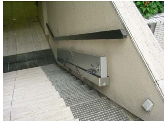
写真 7.2 設置箇所脇に用意されている止水板
